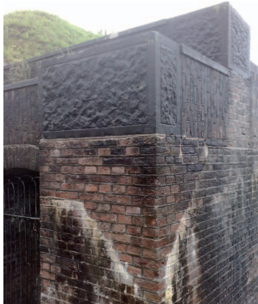
Foto linksboven: Schade aan dakbedekking en metselwerk door verrotte deklatten en losgelaten PVC-folie.
